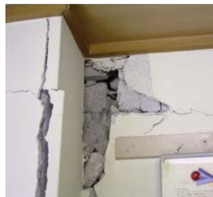
壁が激しく破損。柱は問題ないので安全との事。
